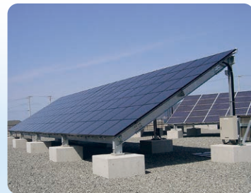
地上設置事例
