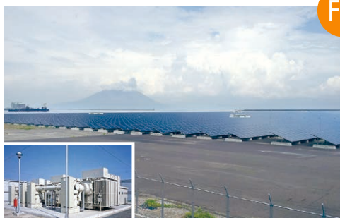
鹿児島七ツ島メガソーラー発電所 様 太陽光発電所に66kV特高設備を納入 70MW 鹿児島県
