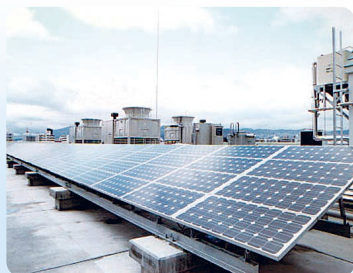
陸屋根設置事例
