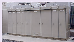
22kVガス絶縁開閉装置
