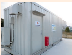
蓄電池収納コンテナ
